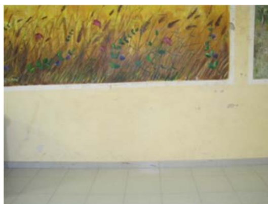
Parete contro-terra oggetto di infiltrazioni
