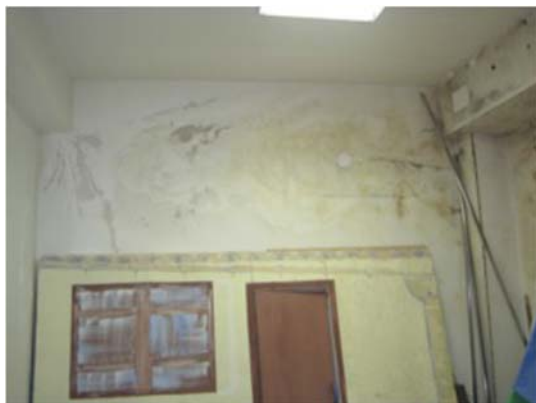
Parete contro-terra oggetto di infiltrazioni
